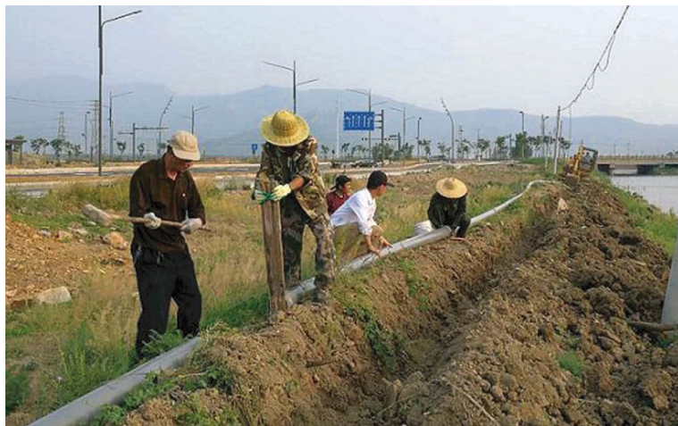
在钙液销售旺季来临之际,为了确保钙液输送管道畅通,保证销售不断档,台北投资公司钙液办公室全体员工主动放弃“双休”,加班加点对受程圩河疏浚影响的3800米钙液输送管道进行全面抢修和迁建,预计将于6月1日前全面完工。(韩挺)
